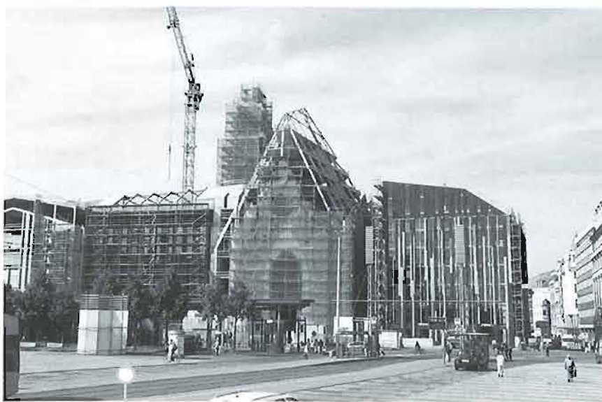
Università di Lipsia: lavori in corso su un nuovo edificio (foto Randy Kühn)
